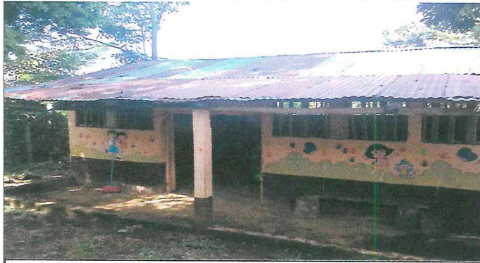
Foto1: Salón de clases con el techo de lámina en mal estado.
