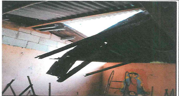
Foto 2: Techo de salón de clases destruido.
