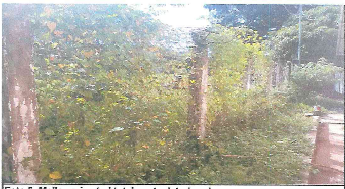
Foto 5: Malla perimetral totalmente deteriorada.
