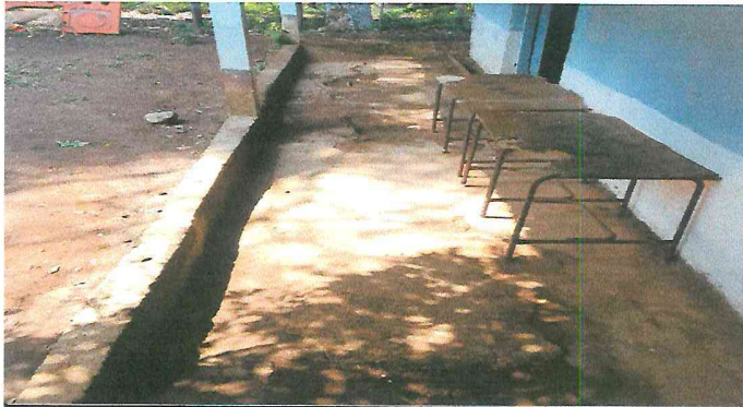
Foto 3: Piso de concreto en mal estado.
